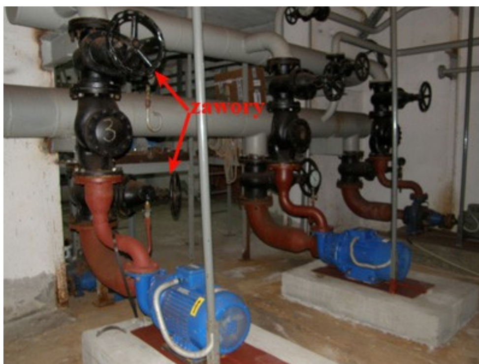
Rys.10 Pompy obiegu wtórnego. Zaznaczone zawory przy pompie nr 3.
