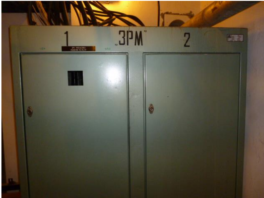
Pomieszczenie 46a („Zasilaczownia” lewa strona).
