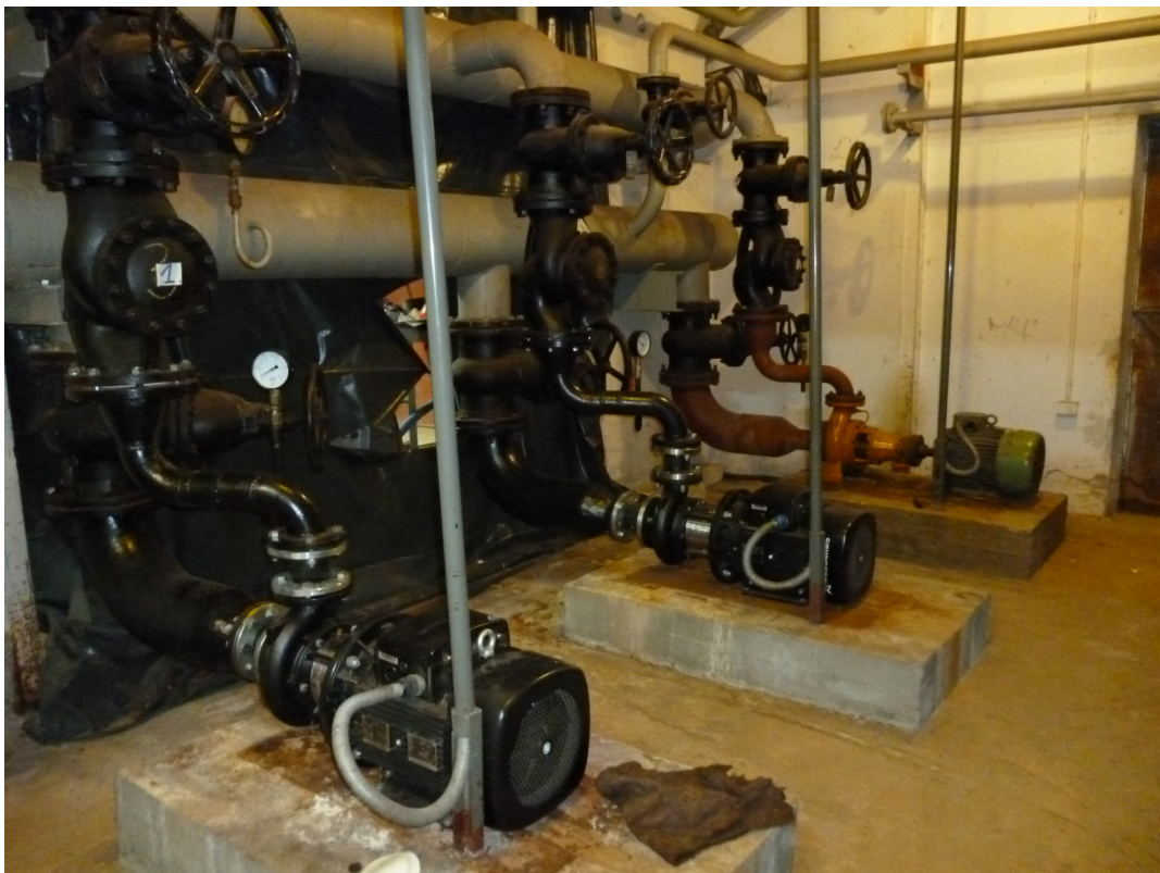
Pompy obiegu wtórnego chłodzenia cyklotronu. Pomieszczenie 030 (Pompownia).
