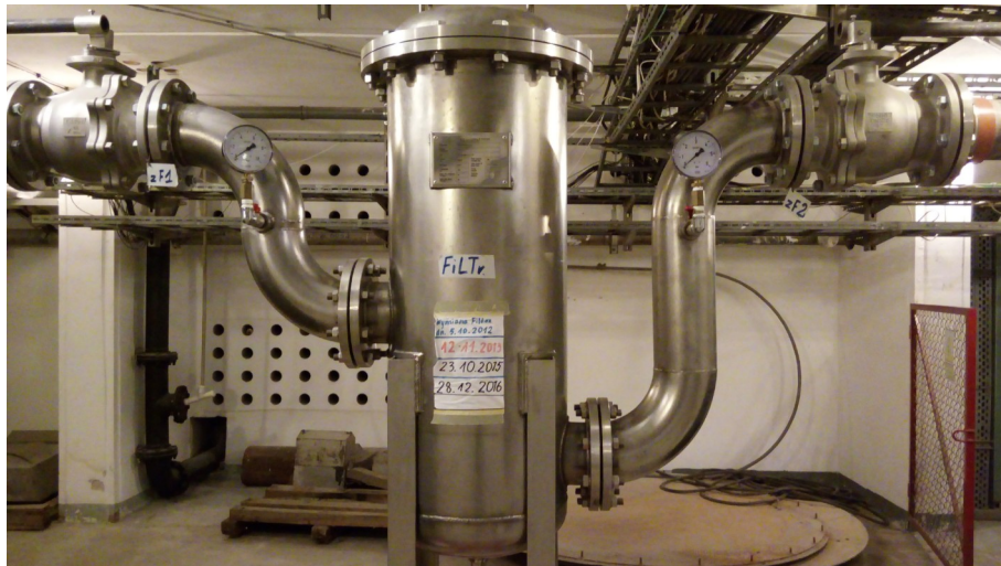
Filtr włókninowy znajdujący się w piwnicy w pomieszczeniu 031.
