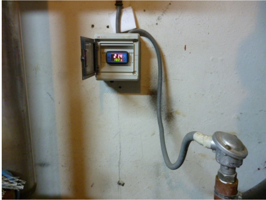
Miernik temperatury wody powrotnej z chłodni na wymienniku w pomieszczeniu 030 (Pompownia).
