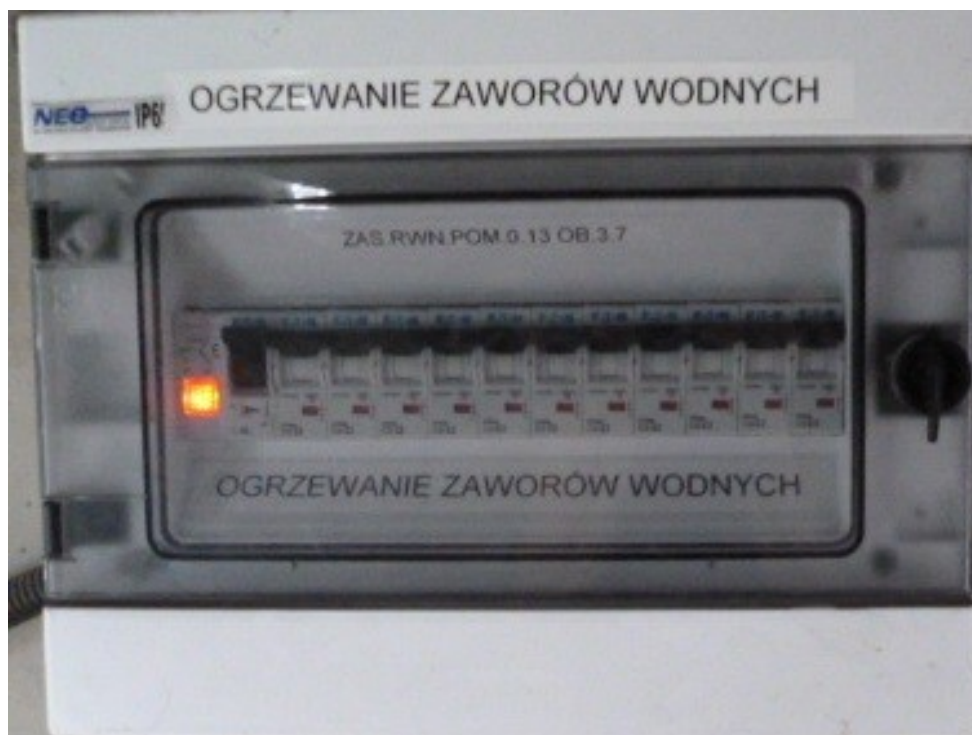
Rozdzielnia ogrzewania zaworów wodnych chłodni kominowych. (Pod chłodnią środkową 13/2 (CH2))
