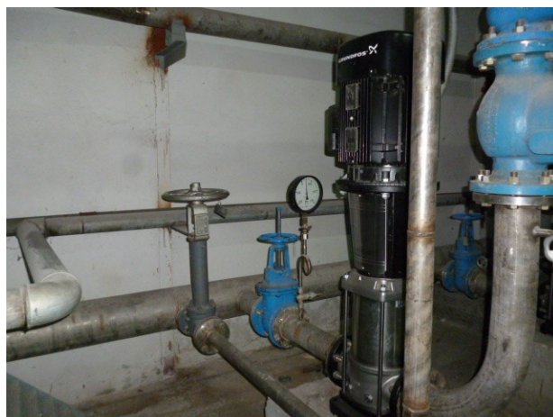
Zawór 1z13 (by-pass) umożliwiający regulację ciśnienia wody w obiegu pierwotnym.
